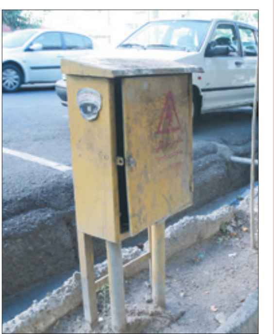
ایمنی در شهر؛ بازبودن در تابلیوی برق در خیابان سنایی
